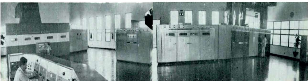
Figura 3. Sala de transmisores, San José de Mosquera, Cundinamarca.
