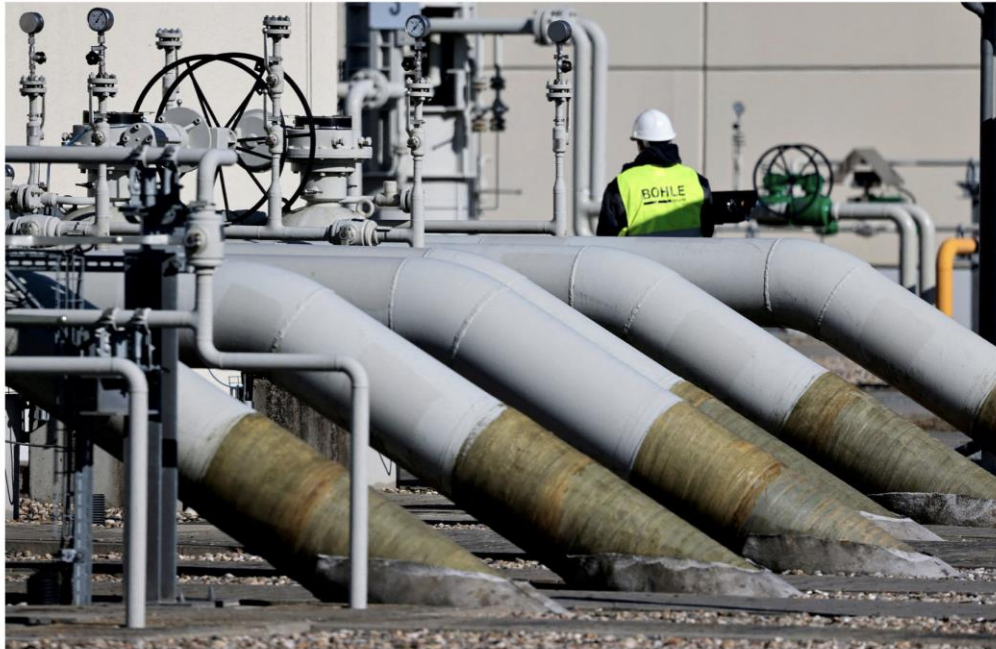
Tuberías del gasoducto Nord Stream en Lumbin, Alemania. HANNIBAL HANSCHKE (REUTERS)
